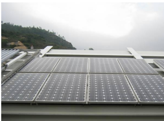
太阳能光伏系统
